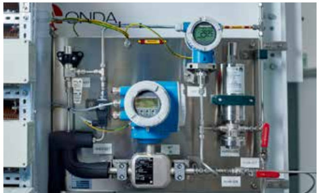
测试系统内安装的其他测量仪表——图例为流量和压力测量仪表
